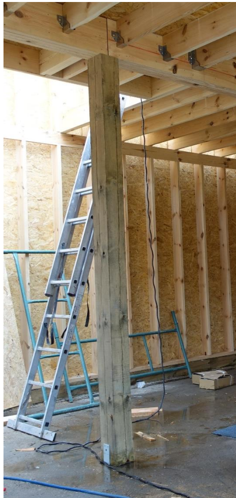
Fotografia 19 - Błędy realizacyjne na budowie z użyciem niewykwalifikowanej kadry.
